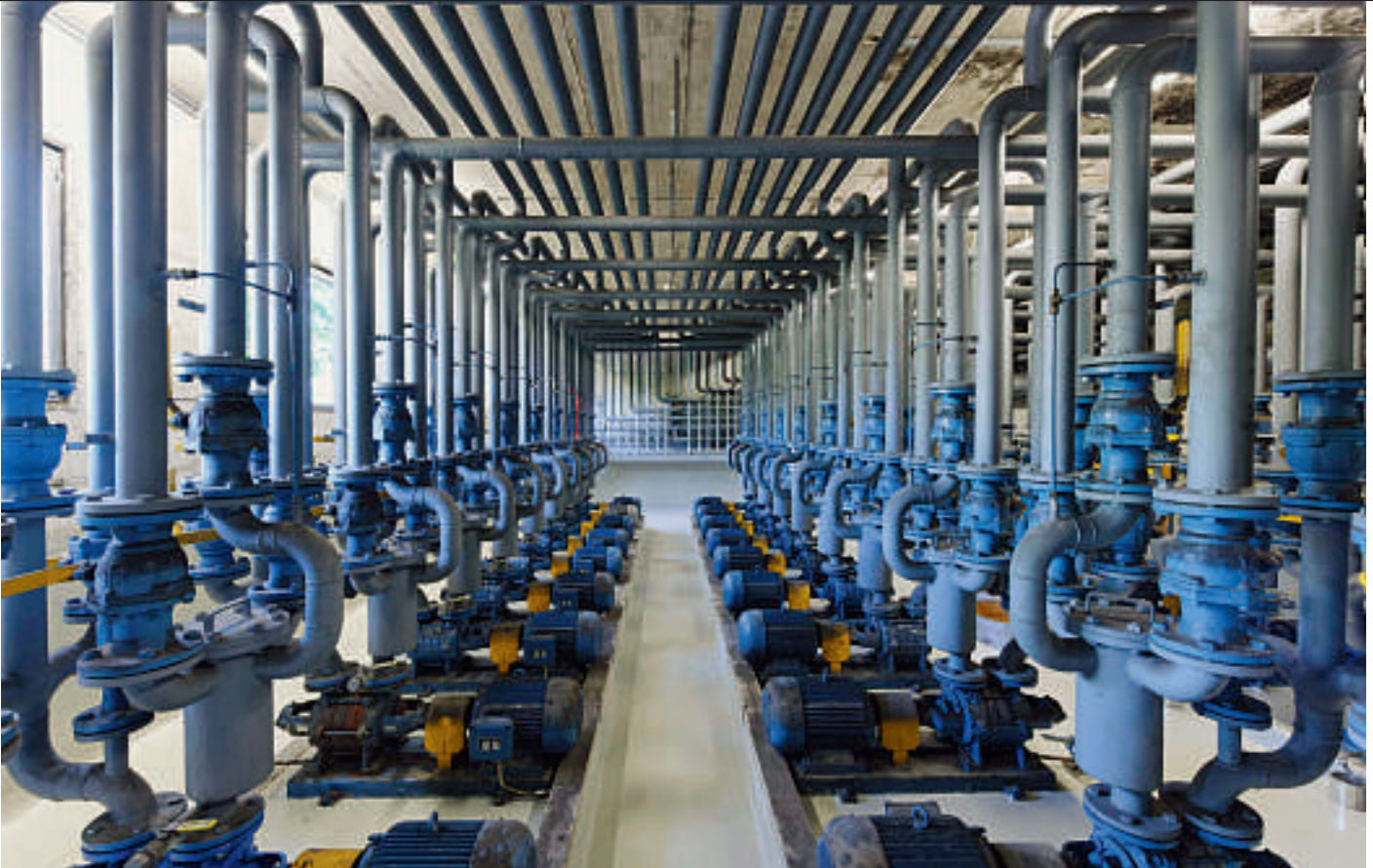
Die Flüssigkeit aus den Tanks kommt über intelligent angebundene Pumpen zur Produktion. Dieser Prozess muss zuverlässig funktionieren
