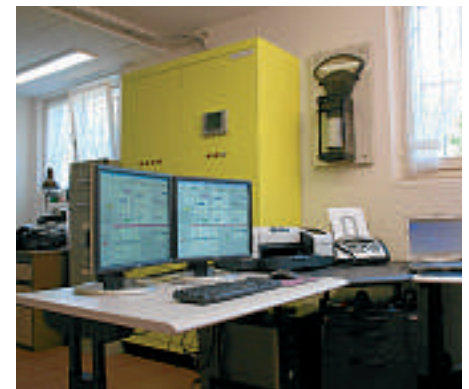
Die gesamte Anlage wird in der Betriebswarte auf zwei grossen LCD-Monitoren dargestellt
