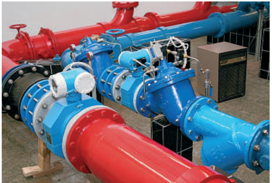
Steuerungstechnik und Leitsystem von Endress+Hauser besitzen ausgewiesene Funktionsmodule für das Wassermanagement
