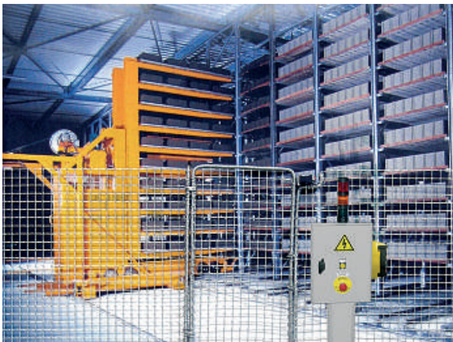
Bild 5: Um den Schiebebühnenbereich bei laufender Anlage zu betreten, weil beispielsweise eine Anomalie überprüft werden soll, nimmt der Bediener den Handsender aus der Ladehalterung und autorisiert sich durch den elektronischen Schlüssel. Wenn ein Mitarbeiter den Bereich ohne Handsender betritt, schaltet sich die Schiebebühne sofort ab
